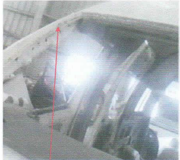
မှန်ပြန်ဖြုတ်ထားသဖြင့် Glue/Sealant အစအနများ
